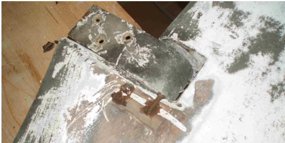
Après avoir gratté l'époxy protégeant les têtes de vis, démonter les en prenant soin de ne pas les casser (bon courage en fonction de leur état !)
